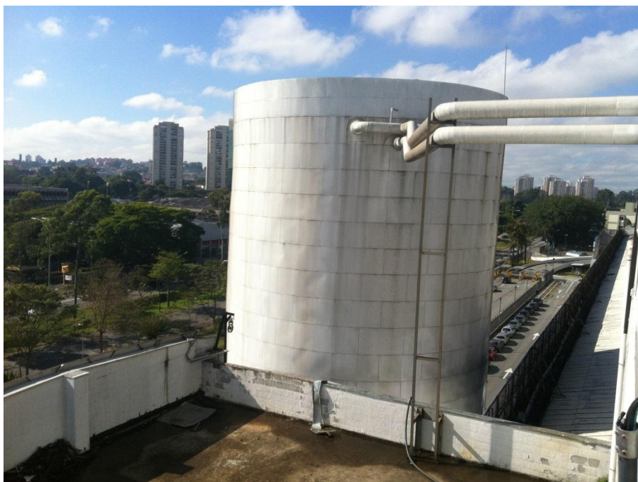
Figura 27 – Foto do tanque de termo acumulação de 3.500.000,00lts de água gelada.
