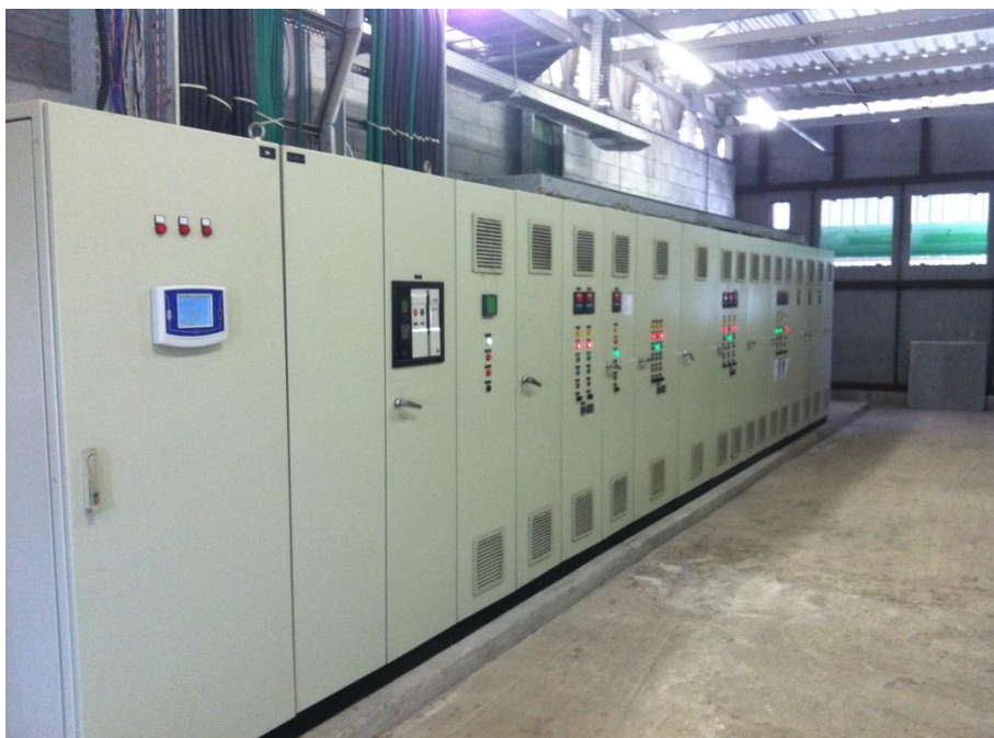
Figura 28 – Foto dos painéis alimentadores elétricos e sistemas e automação das bombas, Chillers , torres de resfriamentos e fan coils .
