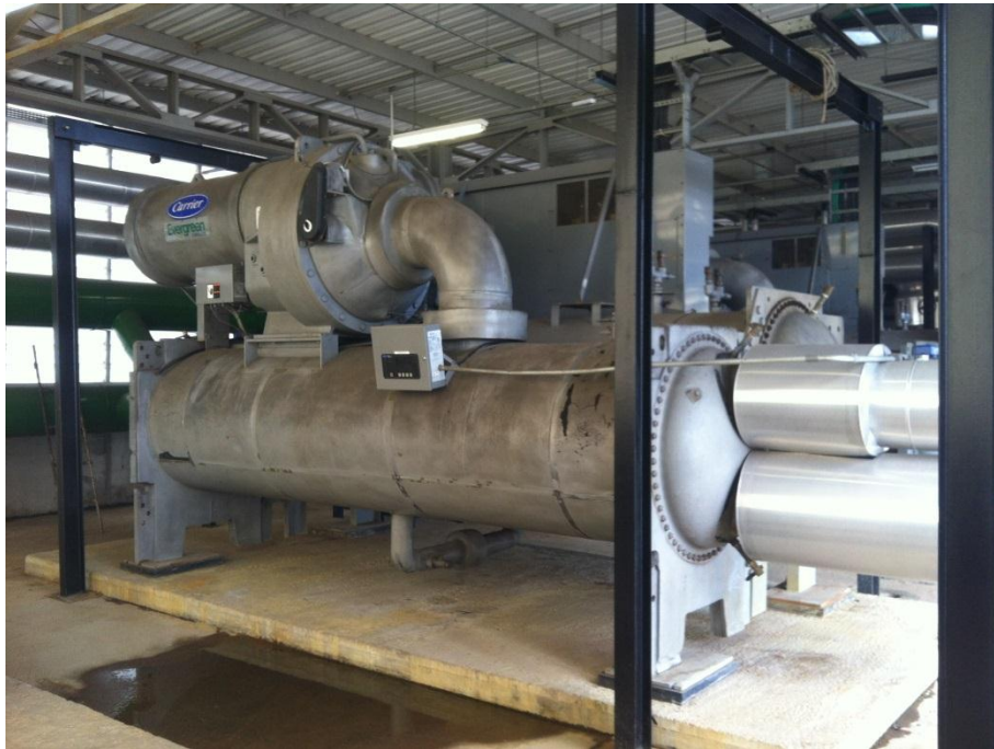
Figura 25 – Chiller Centrifugo da CARRIER de 1.105TR.
