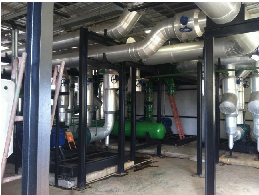
Figura 26 – Bombas de circulação de água gelada para os fan coils , para o tanque de termo acumulação e torres de condensação.
