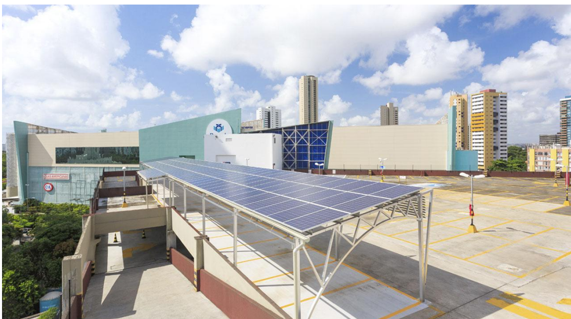
Figura 34 – Foto da cobertura de veículos e placas fotovoltaicas no estacionamento de Shopping Center. Plaza Shopping Recife (2016).
