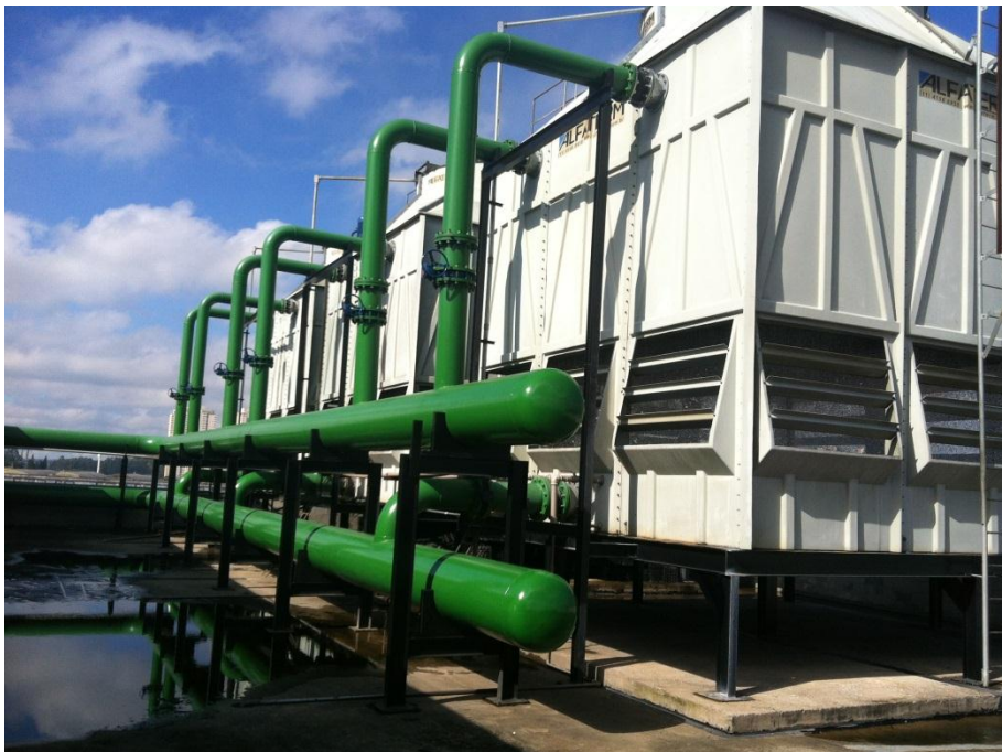
Figura 29 – Foto das torres de resfriamento.
